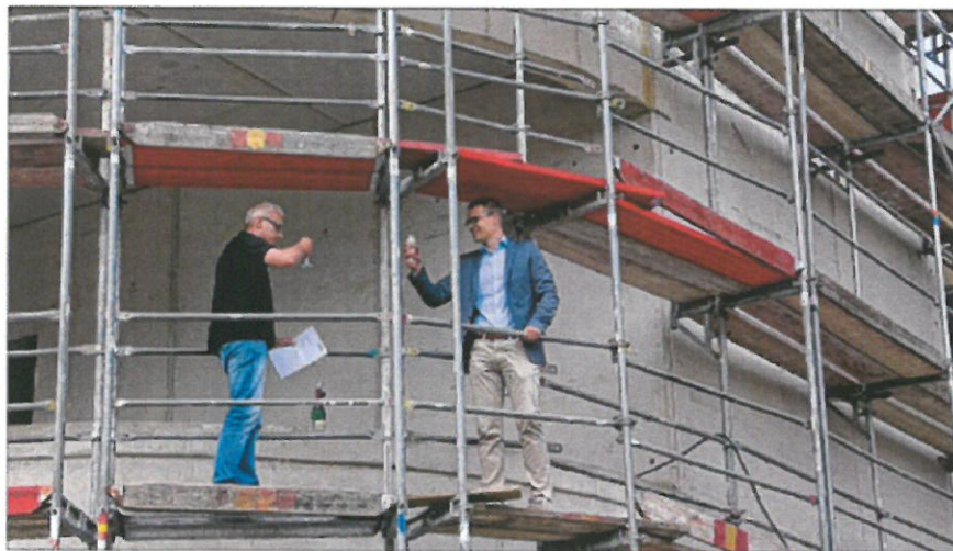
Richtfest: Geschäftsführer Robert Falch (rechts) und Bauleiter Uwe Koch stoßen auf den Neubau an der Hans-Böckler-Straße an. Nebenbei haben die Arbeiten am zweiten Bauabschnitt bereits begonnen. MT-Foto: Henning Wandel
